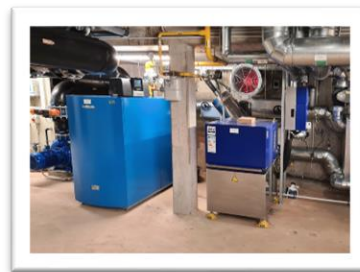
Heizkessel und Blockheizkraftwerk
